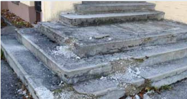
Nicht nur die Stiegen sind baufällig im alten Pfarrheim ...
